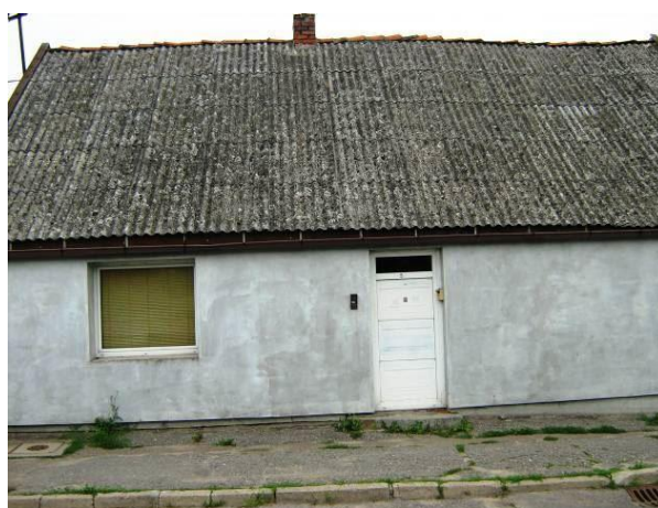
Rys. 7. Pokrycie dachowe ocenione w II stopniu pilności
