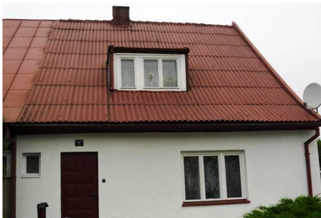
Rys. 6. Pokrycie dachowe ocenione w III stopniu pilności
