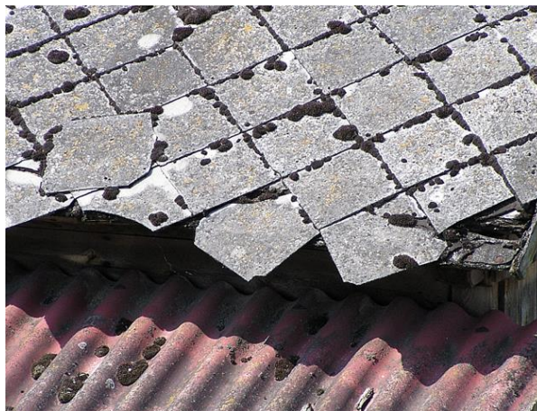
Rys. 8. Pokrycie dachowe ocenione w I stopniu pilności
