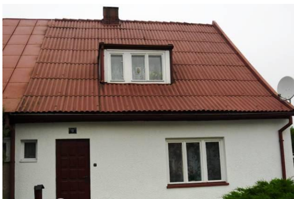
Rys. 6. Pokrycie dachowe ocenione w III stopniu pilności.
