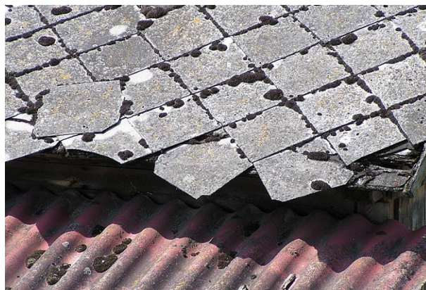
Rys. 8. Pokrycie dachowe ocenione w I stopniu pilności.
