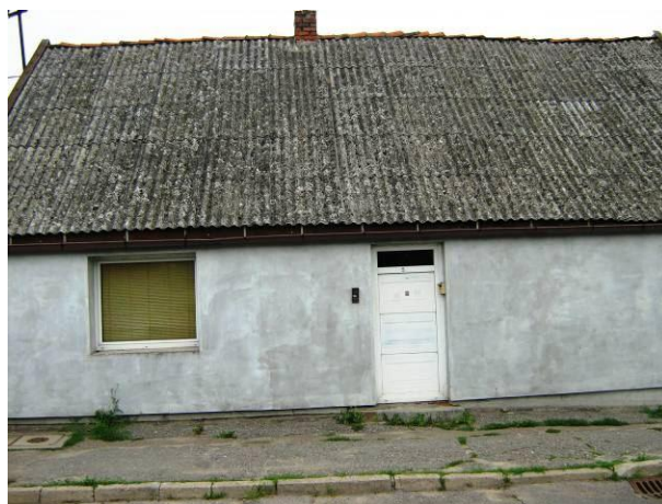
Rys. 7. Pokrycie dachowe ocenione w II stopniu pilności.
