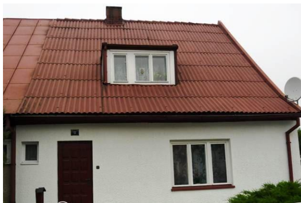
Rys. 6. Pokrycie dachowe ocenione w III stopniu pilności
