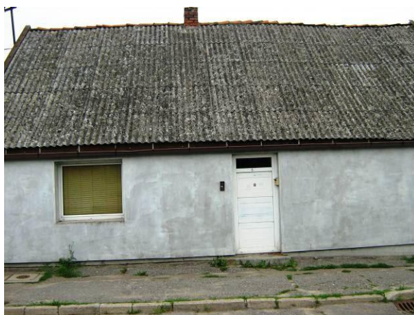
Rys. 7. Pokrycie dachowe ocenione w II stopniu pilności
