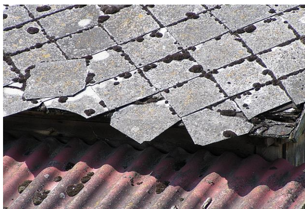
Rys. 8. Pokrycie dachowe ocenione w I stopniu pilności
