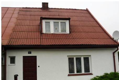
Rys. 6. Pokrycie dachowe ocenione w III stopniu pilności.
