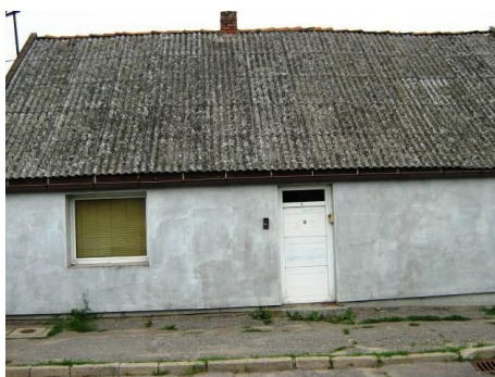
Rys. 7. Pokrycie dachowe ocenione w II stopniu pilności.
