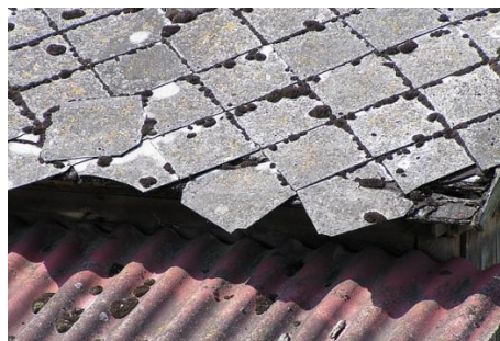
Rys. 8. Pokrycie dachowe ocenione w I stopniu pilności.
