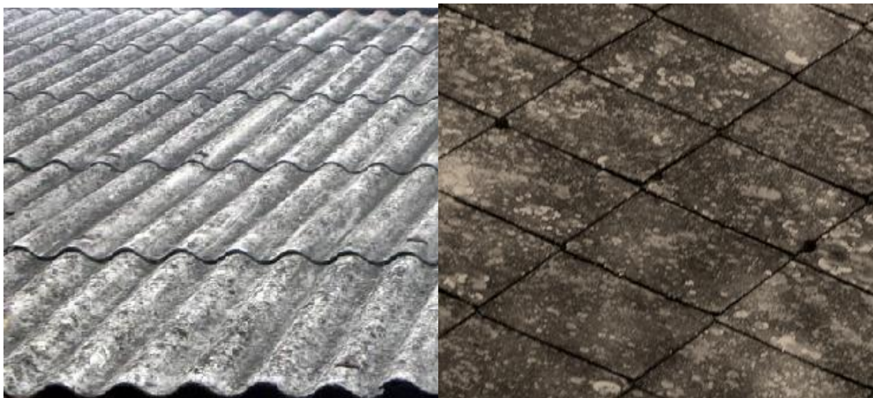
Rys. 1 Pokrycia dachowe zawierające azbest: płyty płaskie (po prawej) oraz faliste (po lewej) (źródło: materiały własne)
