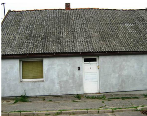
Rys. 7. Pokrycie dachowe ocenione w II stopniu pilności
