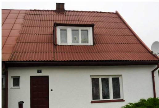
Rys. 6. Pokrycie dachowe ocenione w III stopniu pilności
