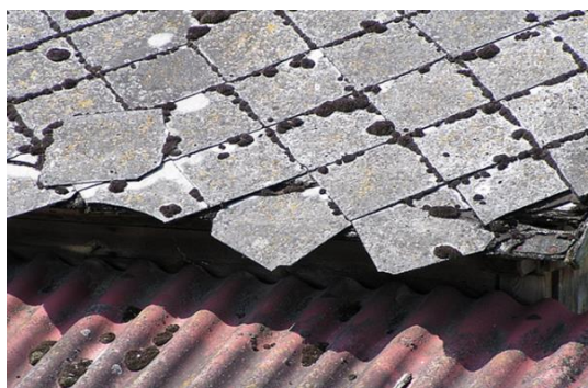
Rys. 8. Pokrycie dachowe ocenione w I stopniu pilności
