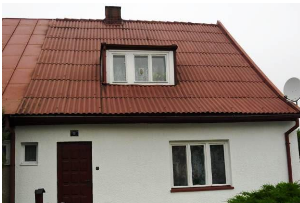
Rys. 6. Pokrycie dachowe ocenione w III stopniu pilności.
