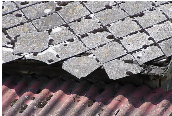
Rys. 8. Pokrycie dachowe ocenione w I stopniu pilności
