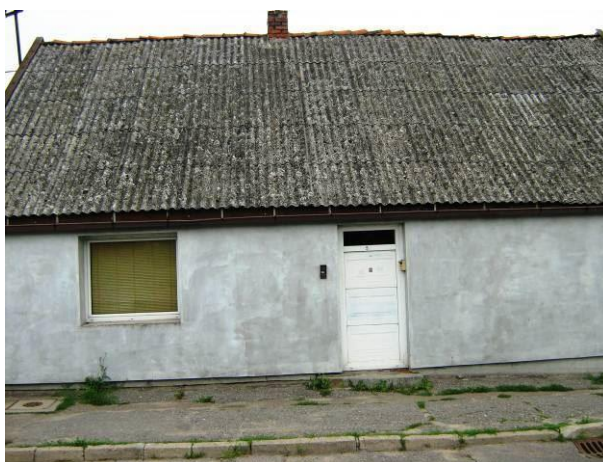
Rys. 7. Pokrycie dachowe ocenione w II stopniu pilności
