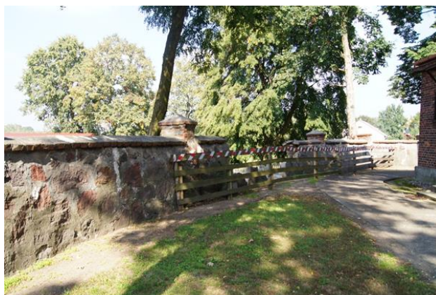
Stare Skoszewy ogrodzenie kościoła wymagające przeprowadzenia prac naprawczych
