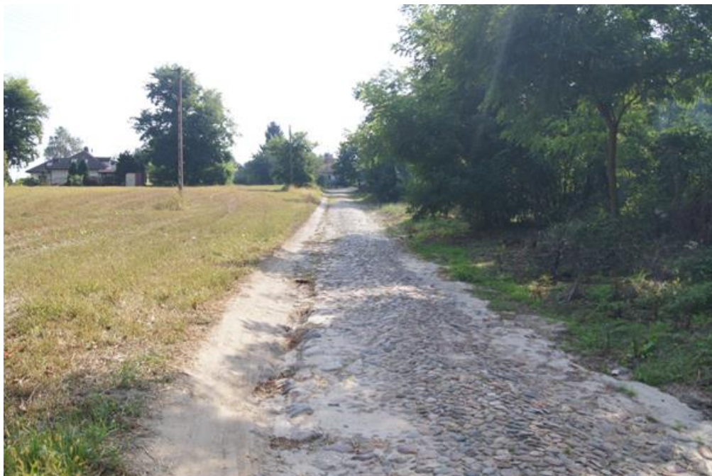
Budulec lokalny w nawierzchni drogi
