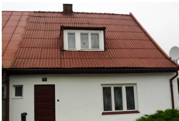
Rys. 6. Pokrycie dachowe ocenione w III stopniu pilności.
