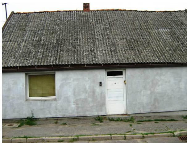
Rys. 7. Pokrycie dachowe ocenione w II stopniu pilności.
