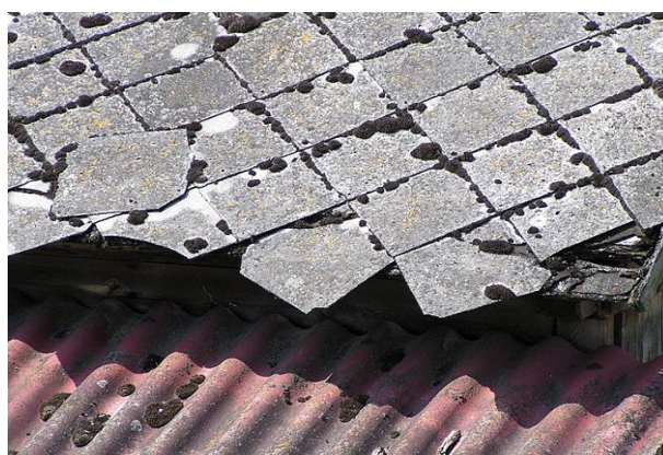
Rys. 8. Pokrycie dachowe ocenione w I stopniu pilności.
