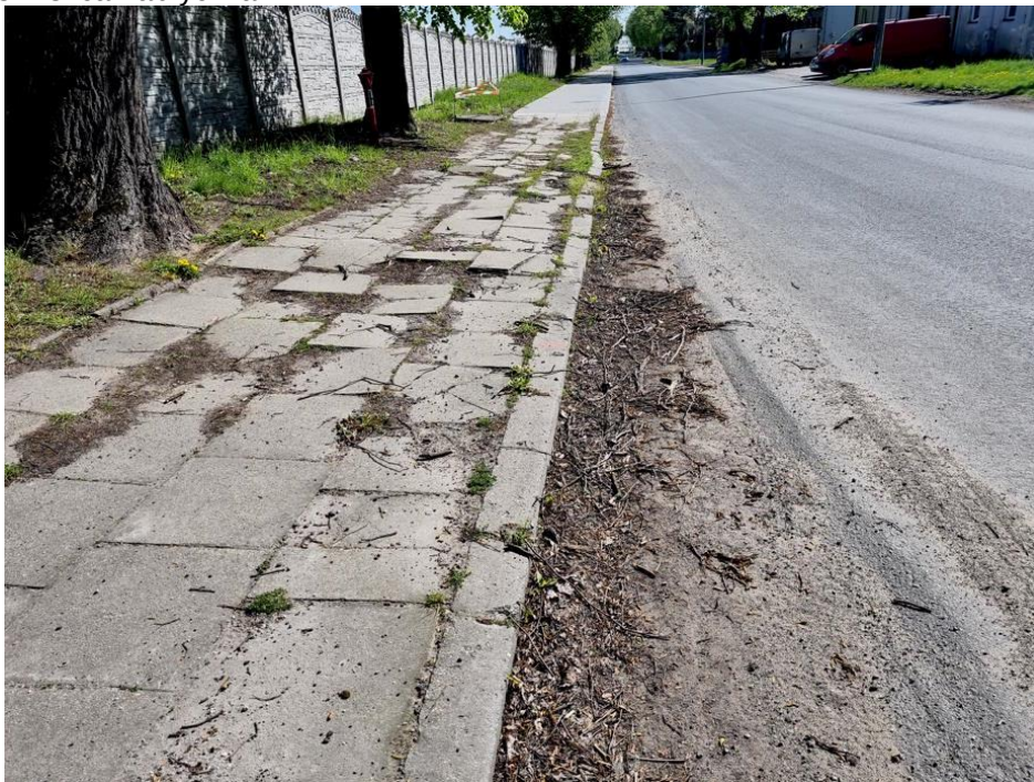
Fotografia 32. Ulica Fabryczna – stan chodników
