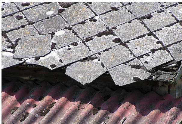
Rys. 8. Pokrycie dachowe ocenione w I stopniu pilności.
