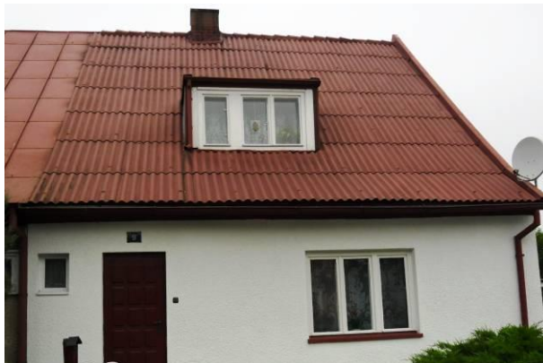
Rys. 6. Pokrycie dachowe ocenione w III stopniu pilności.
