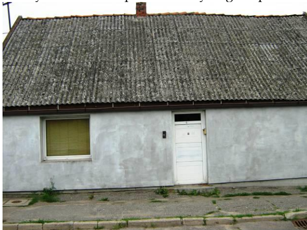
Rys. 7. Pokrycie dachowe ocenione w II stopniu pilności.
