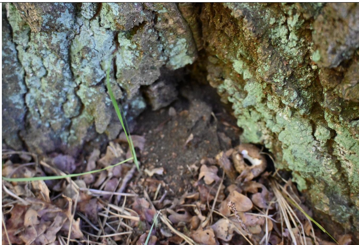
Zdj.7. Miejsce niewielkiego uszkodzenia odziomka pomiędzy nabiegami korzeniowymi wraz z owocnikami grzybów
