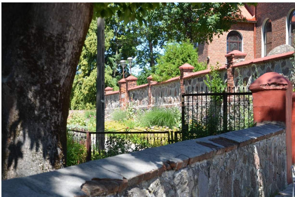
Ogrodzenie Sanktuarium w Starych Skoszewach wymagające dalszych prac naprawczych
