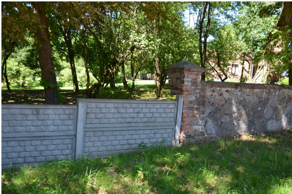
Stare Skoszewy - ogrodzenie kościoła po przeprowadzonych pracach nie nawiązujących do stylu pierwotnego założenia
