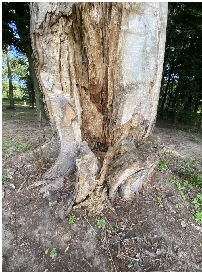
Klon srebrzysty - Acer saccharinum zlokalizowany na działce nr 56 w miejscowości Nacesławice, obręb geodezyjny Nacesławice, gmina Błaszki.
