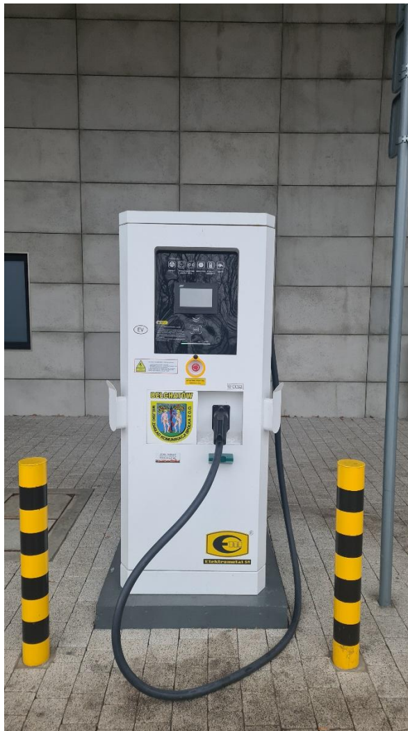
Rysunek 9 Stacja ładowania autobusów elektrycznych zlokalizowana na węźle przesiadkowym
