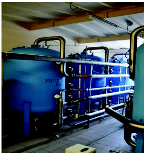
Zmodernizowana stacja uzdatniania wody w Twierdzy Modlin
