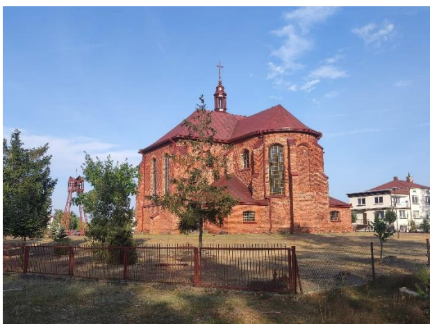
Kościół pod wezwaniem Św. Trójcy w Chotczy Dolnej z widocznymi uszkodzeniami (widok od strony północnej, zachodniej i południowej)
