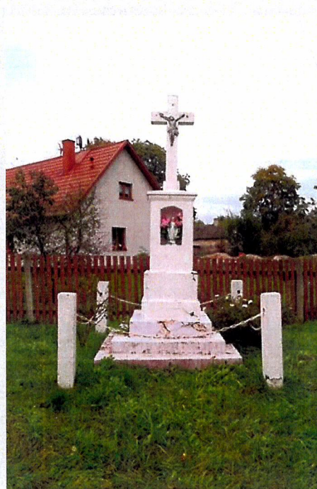
Kapliczka w Ostrówce -widoczne pęknięcia w obrębie podstawy i cokołu.
