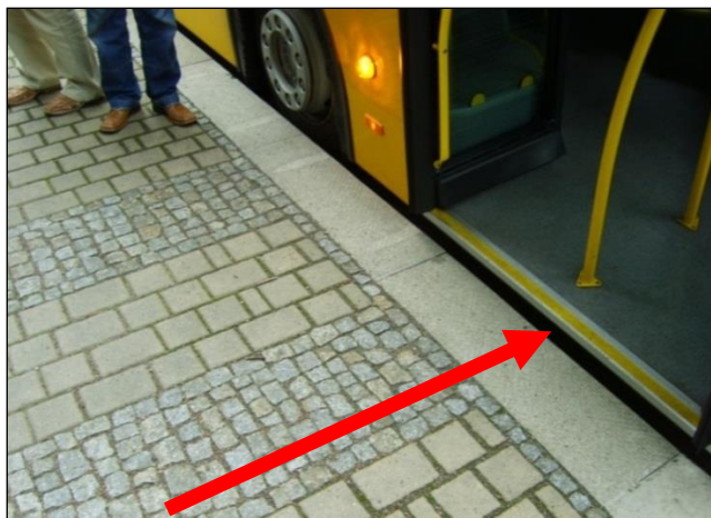
Rys. 8.5.2.2. Strefa wejściowa – inny rodzaj nawierzchni naprzeciwko pierwszych drzwi autobusu. Źródło: opracowanie własne.
