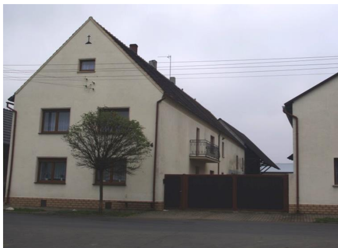
Budynek dobrze utrzymany, z przekształconymi otworami okiennymi i ahistorycznym okapem.
