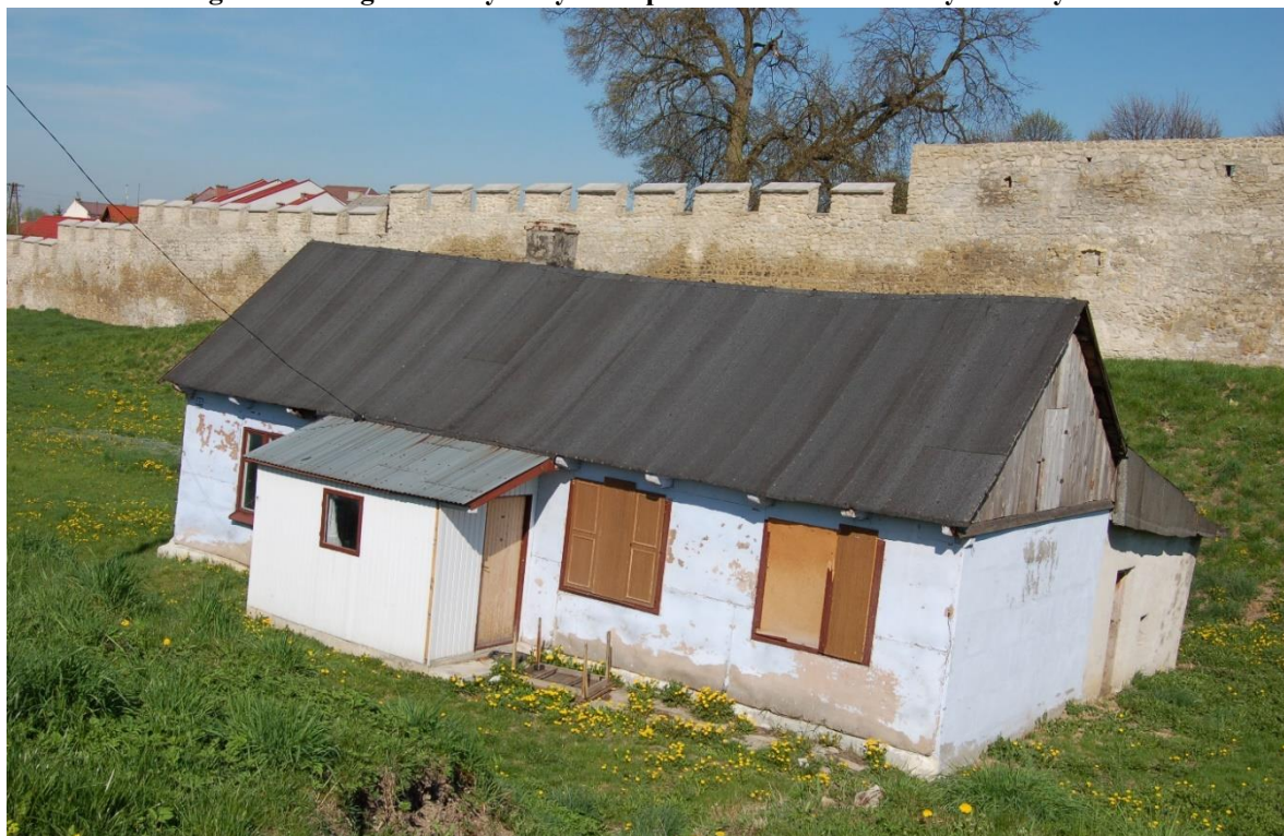
Fotografia 8 Zdegradowany budynek u podnóża murów obronnych w Szydłowie
