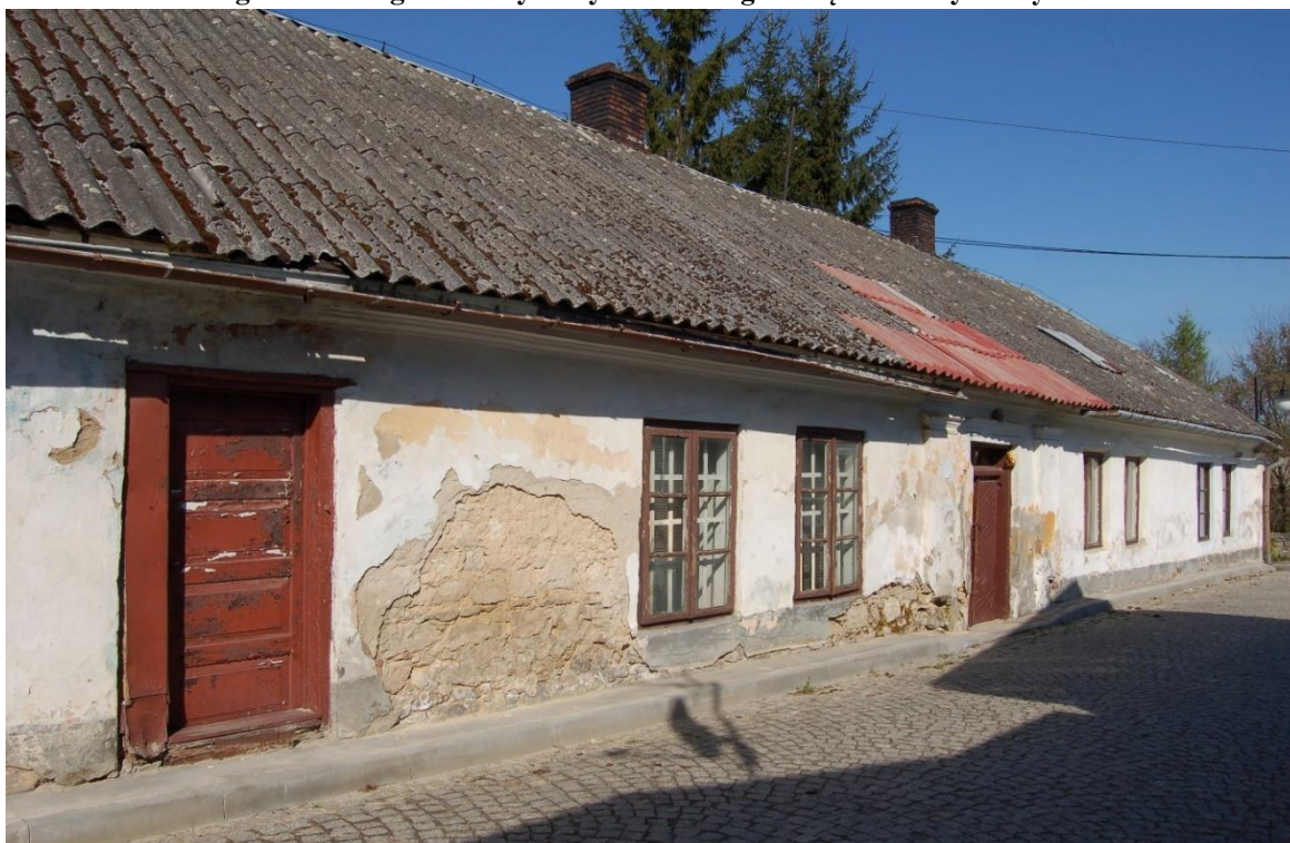
Fotografia 2 Zdegradowany budynek dawnego Urzędu Gminy w Szydłowie
