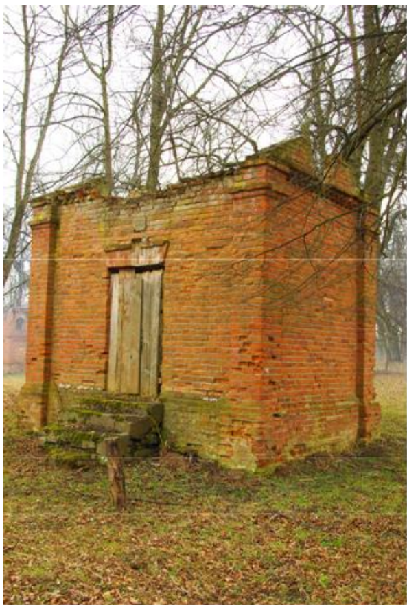
Ruiny budynku studni głębinowej
