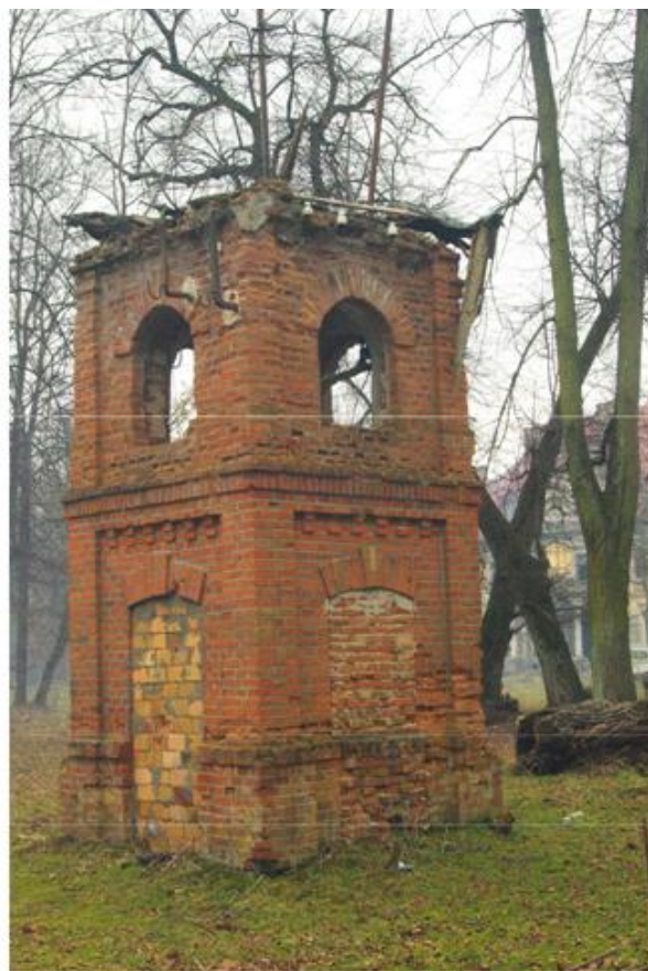
Ruiny budynku transformatora
