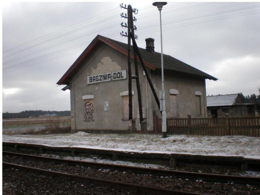
Fotografia 2 Zdegradowany budynek stacji kolejowej Basznia Dolna
