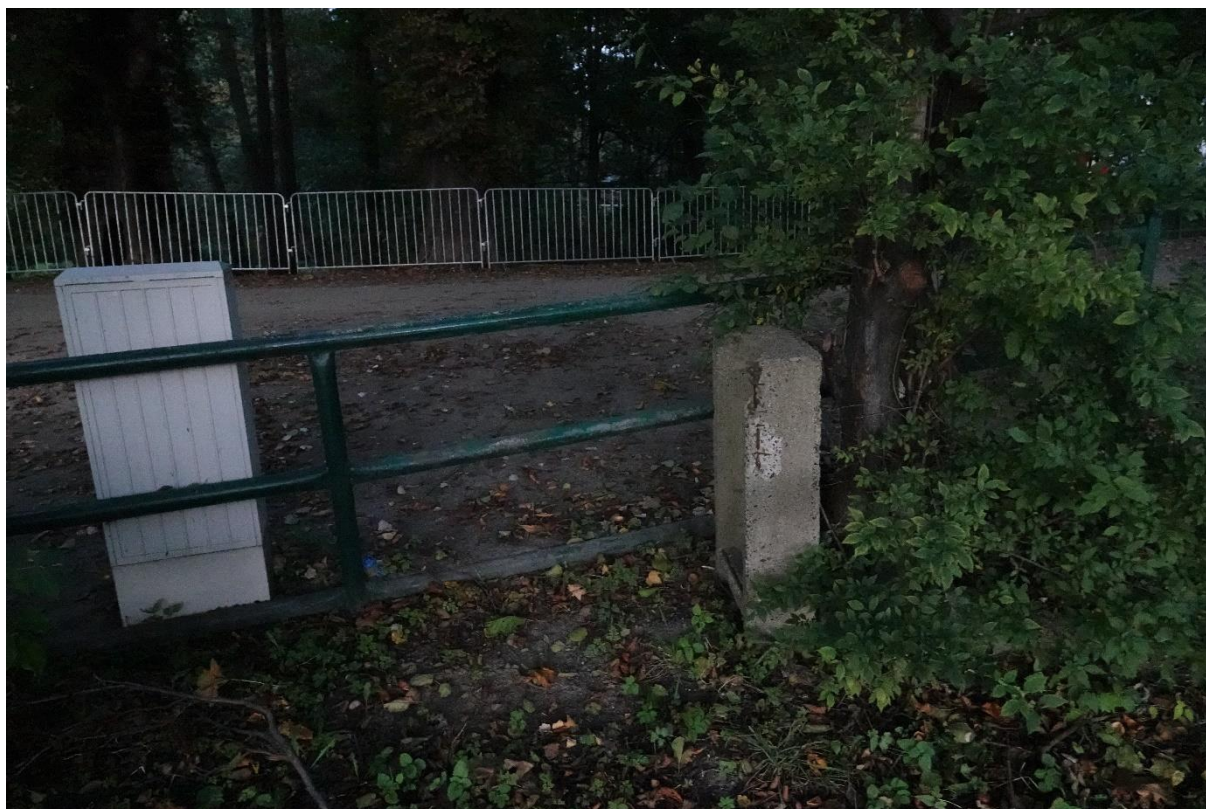
Fot. 23 Skrzynki od instalacji technicznych.
