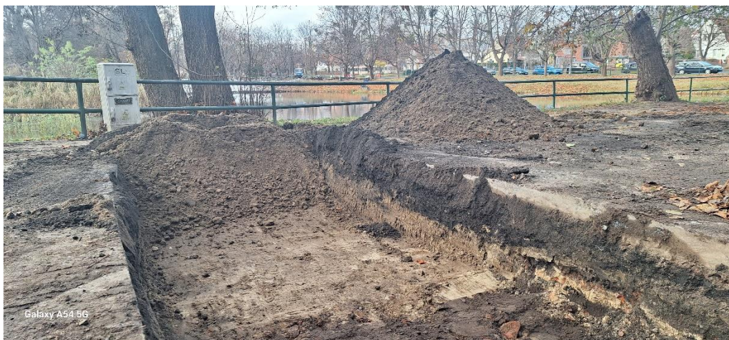
Fot. 4 Brak korzeni w głównym wykopie.
