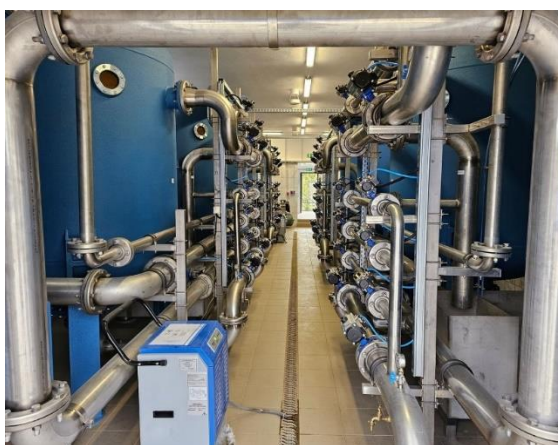
Zdjęcie nr 3 Rozbudowa stacji uzdatniania wody w Jabłowie, Gmina Starogard Gdański
