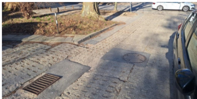
Fot. 8 Instalacje podziemne w strefie SOD drzewa nr 58b.
