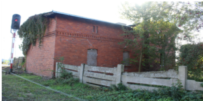
Ilustracja 142. Silno ul. Dworcowa 56, budynek kolejowy.
