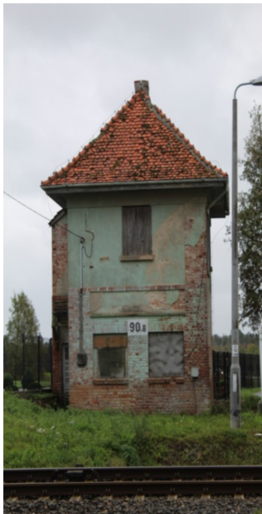
Ilustracja 154. Krojanty ul. 18 Pułku Piechoty Ułanów Pomorskich 2, transformatorownia.
