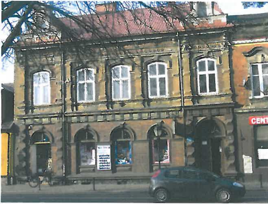
Zdjęcie 25, 26. Budynek Plac Kościuszki 5 – wymagany remont:
