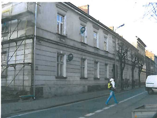
Zdjęcie nr 29, 30. Budynek Jagielly 26 – wymagany remont:
