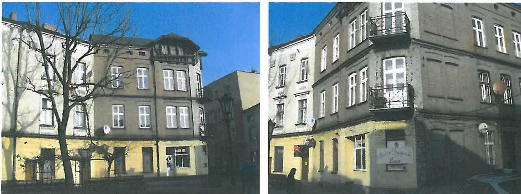
Zdjęcie nr 16 i 17. Budynek Mickiewicza 4 – wymagający remontu:
