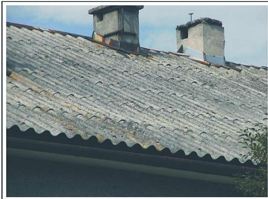
Fot.2 Pokrycie dachowe budynku mieszkalnego z płytek falistych - II stopień pilności
