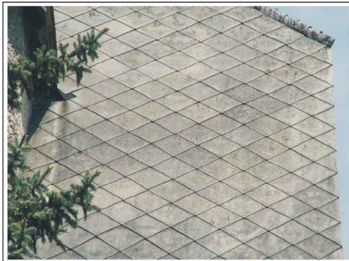
Fot.4 Pokrycie dachowe budynku mieszkalnego z płytek typu "caro" - III stopień pilności
