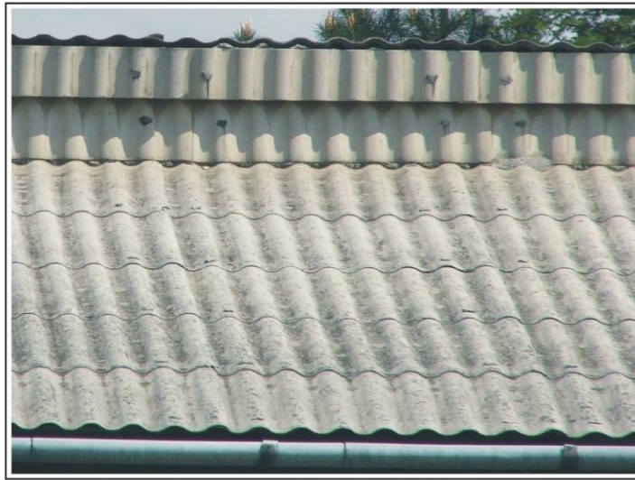
Fot.3 Pokrycie dachowe budynku mieszkalnego z płyt falistych - III stopień pilności
