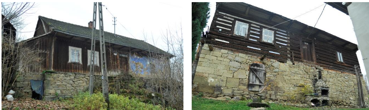
Ryc. 13 Budynki mieszkalne posadzone na wysokich fundamentach w Harbutowicach Źródło: fot. Katarzyna Michniowska
