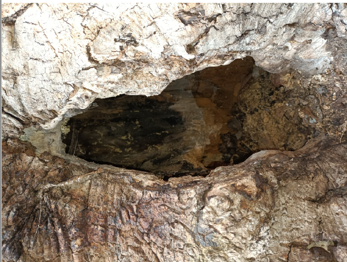
Ubytki w obrębie pnia jesionu wyniosłego nr 14
