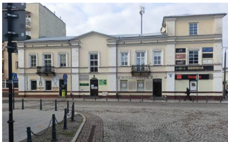
Ryc. 4. Nadmierna ilość szyldów reklamowych na elewacji
