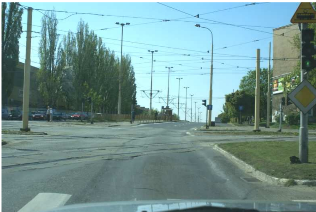
Fot. 6.1-34 Stan jezdni drogi jak i linii tramwajowej na odcinku ul. Dubois i Firlika jest bardzo zły.
