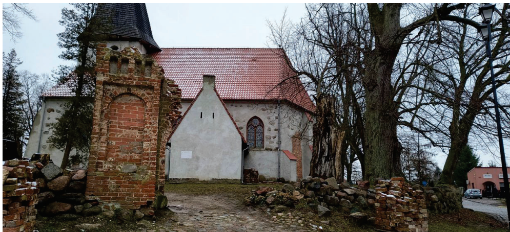
Ryc. 55. Zniszczona zabytkowa bramka przy kościele w Łątku; fot. Edyta A. Marek
