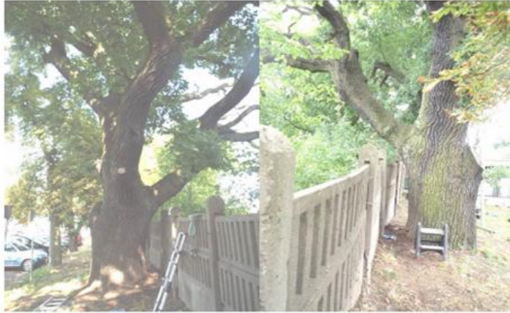
Fot. 3 – 4: Dąb szypułkowy ( Quercus robur ) „Zawiadowca”; Rany po amputacjach, podwyższenie poziomu gruntu. 15.07.2015
