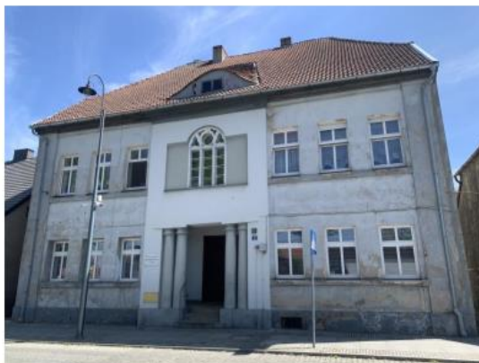
Fot. 74. Sąd, obecnie dom mieszkalny, Plac Karola Marcinkowskiego 9 w Rogoźnicy, nr rejestru A-155/309 z 21.10.1968 r. (fot: A. Bąk, A. Nagórna, 2023)
