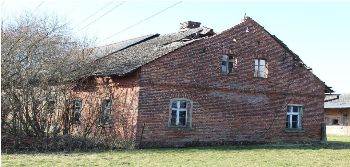
Ilustracja 55. Królówka, ul. Pisarka 50. Budynek mieszkalno – gospodarczy w bardzo złym stanie zachowania.
