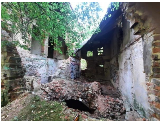
Fot.47 Nowy Dwór 3, ruina dworu.
